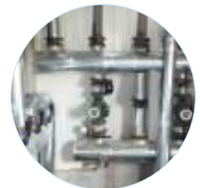
Pompe de Circulation
